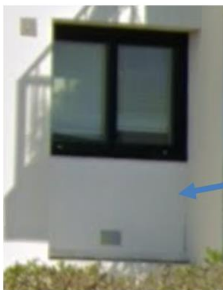
Allèges cuisine à isoler
